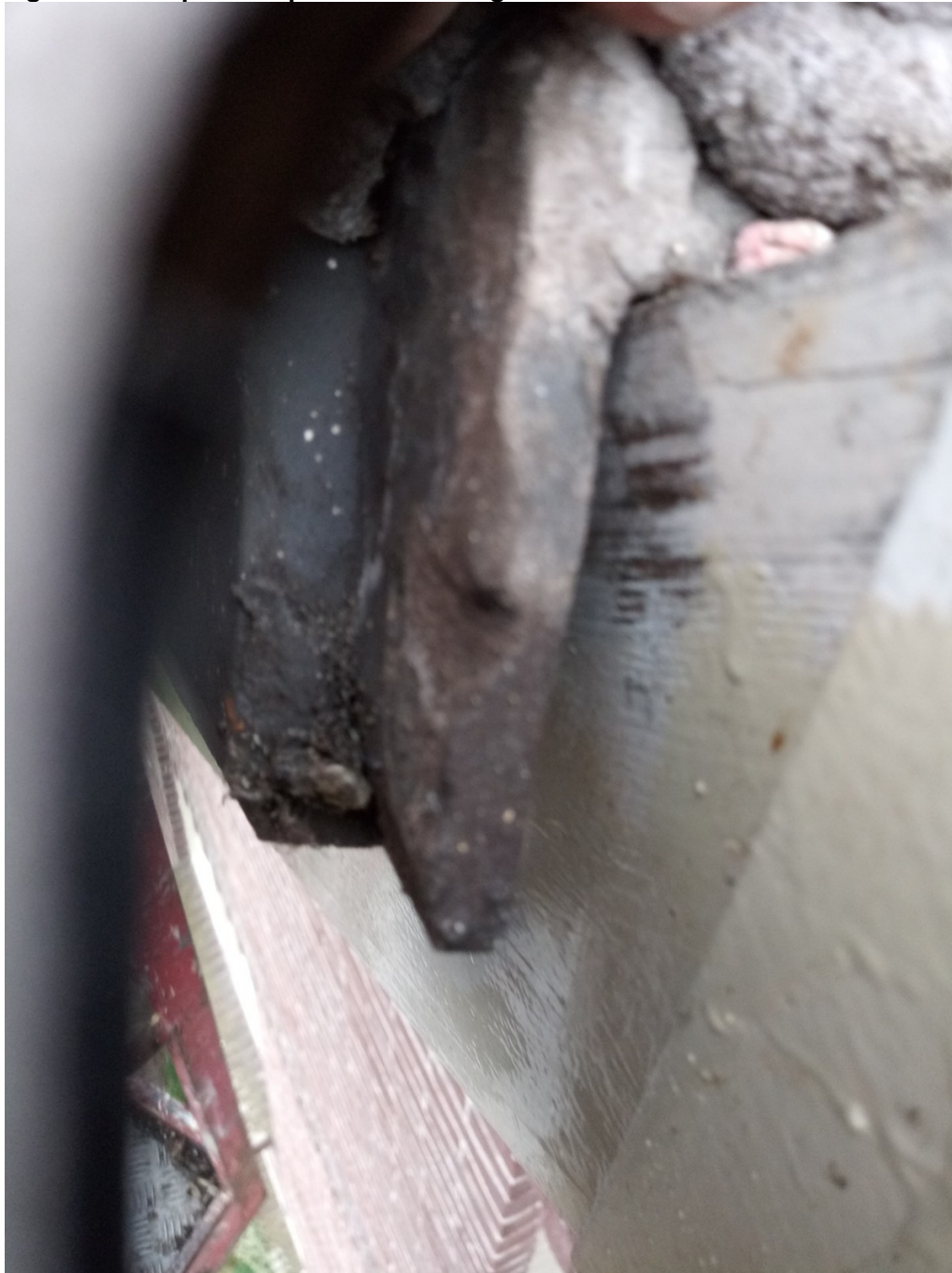
Figuur 3. Gevelpannen op dakbetimmering.
