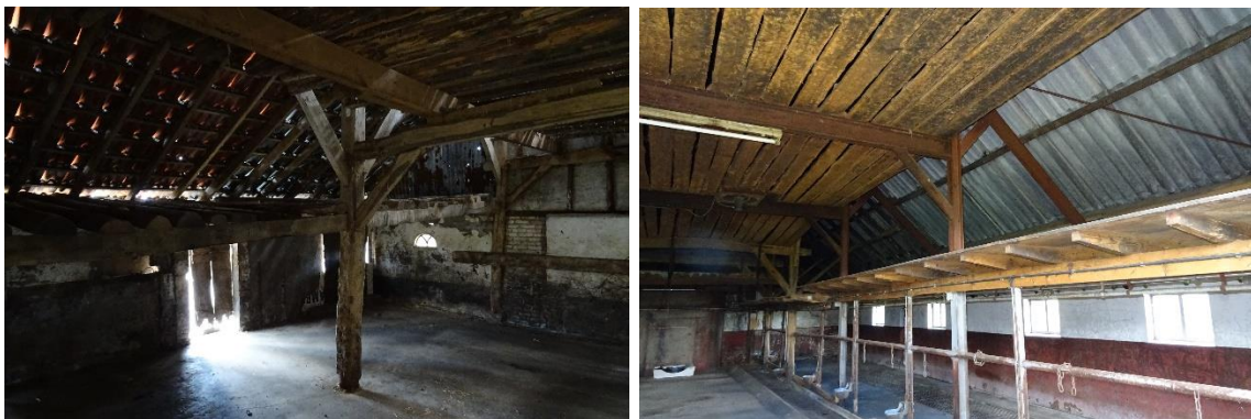
Afbeelding 13 en 14: Daken oude schuur en achterhuis zonder dakbeschot. Huismussen of sporen van huismussen zijn niet aangetroffen. Bron: R.J.L. Bijvelds 15-07-2020
