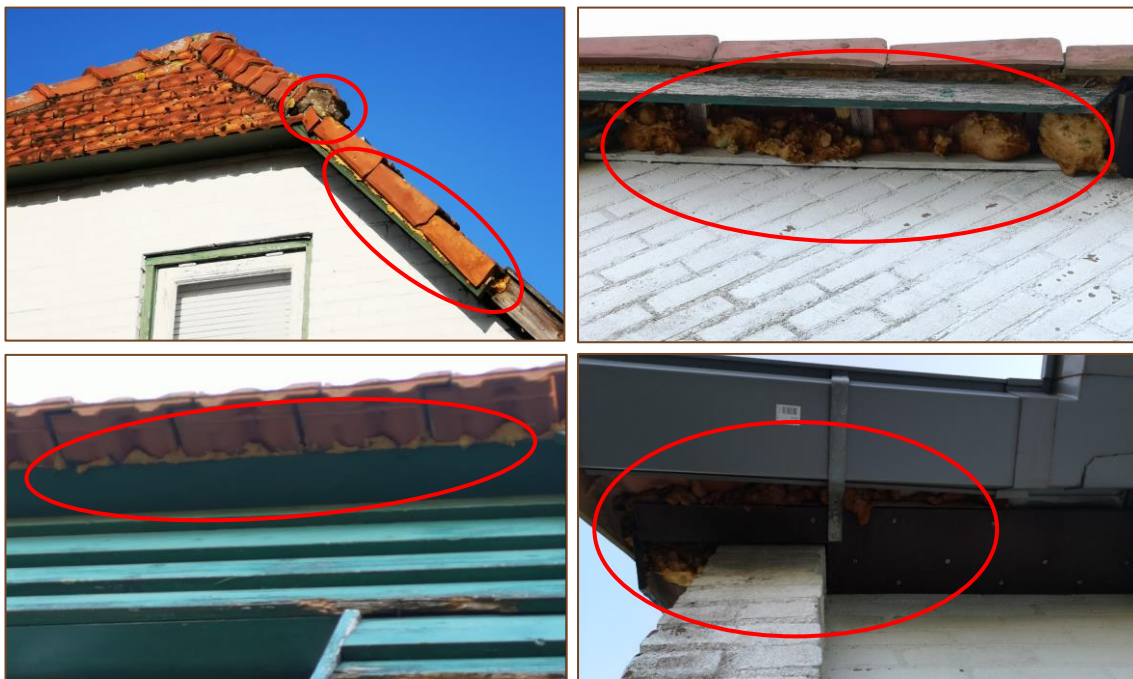
Foto 1 t/m 4. Potentielle invliegopeningen aan de te renoveren woning zijn dichtgemaakt (foto's: R. Boerboom).
