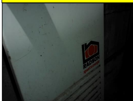
Schuur 2, CV-hok: Radson CV-ketel (M010)
