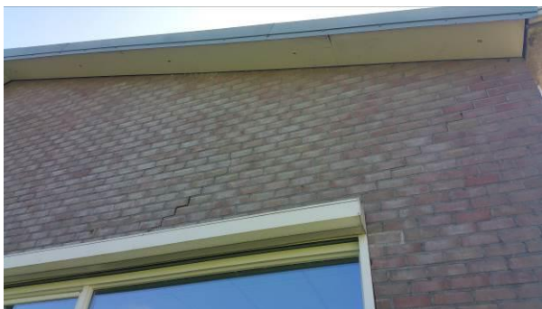
Foto 5: Kier tussen bakstenen muur en gevelbetimmering bedrijfshal
