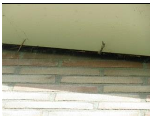
Figuur 10. Nestresten achter de dakrand.
