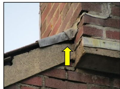
Figuur 19. Invliegopening onder loodslab dat toegang biedt tot de spouw in de schoorsteen.
