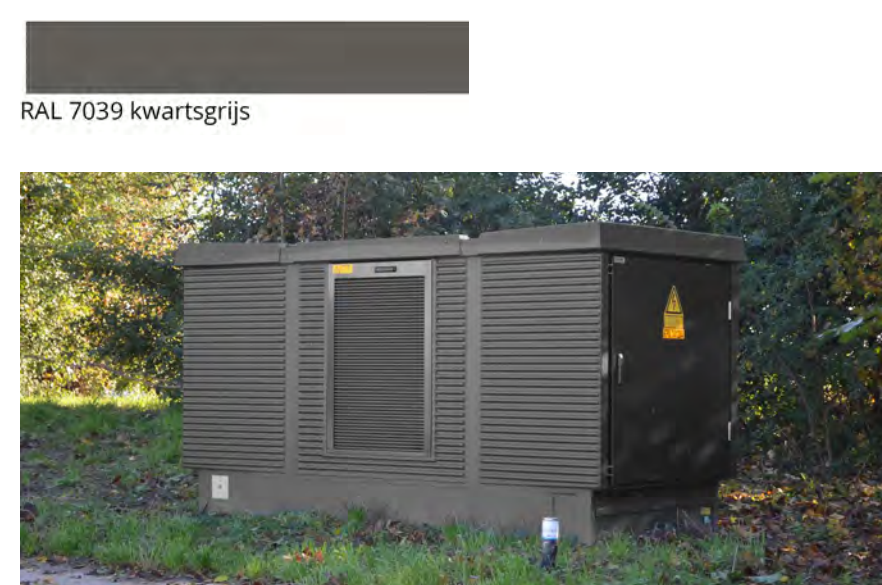
Afbeelding 18. Kleurgebruik en uitstraling transformator, overige installaties en bouwwerken.
