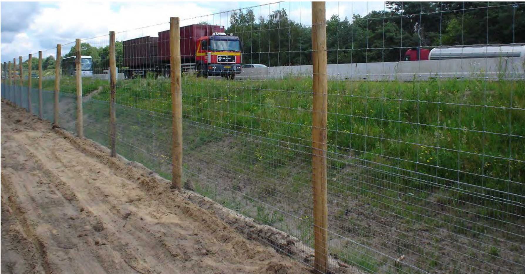
Afbeelding 16. Hekwerk N18 onderzijde (tot 100 cm) fijn gaas, 20 cm ingegraven en bovenzijde grof gaas.
