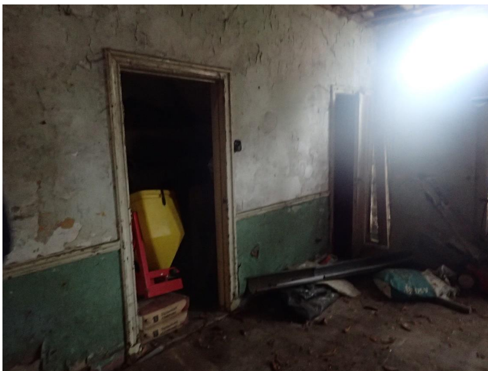
Figuur 15. Wandafwerkingen, kleurstelling en kozijnen zijn deels nog origineel, maar de wandafwerking is deels in slechte staat (foto: RAAP, 14 oktober 2021).
