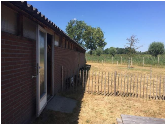
Figuur 8: Asbestgolfplaten zonder dakgoot.
