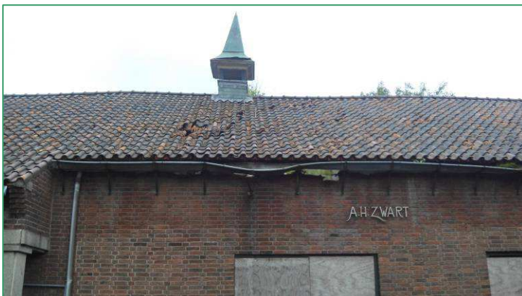
Voorzijde Zwartschool. Zichtbaar zijn de vele scheluwe en kapotte dakpannen en verzakte dakgoot.
