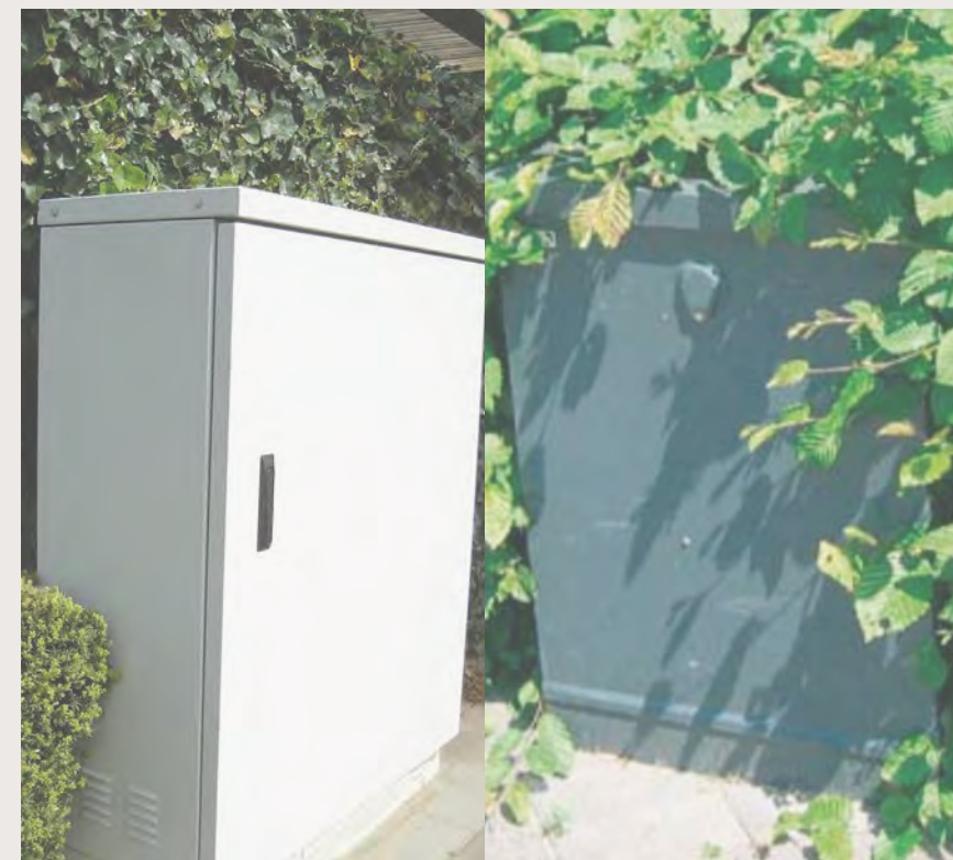
Kabelkasten niet naast, maar in de haagstrook
