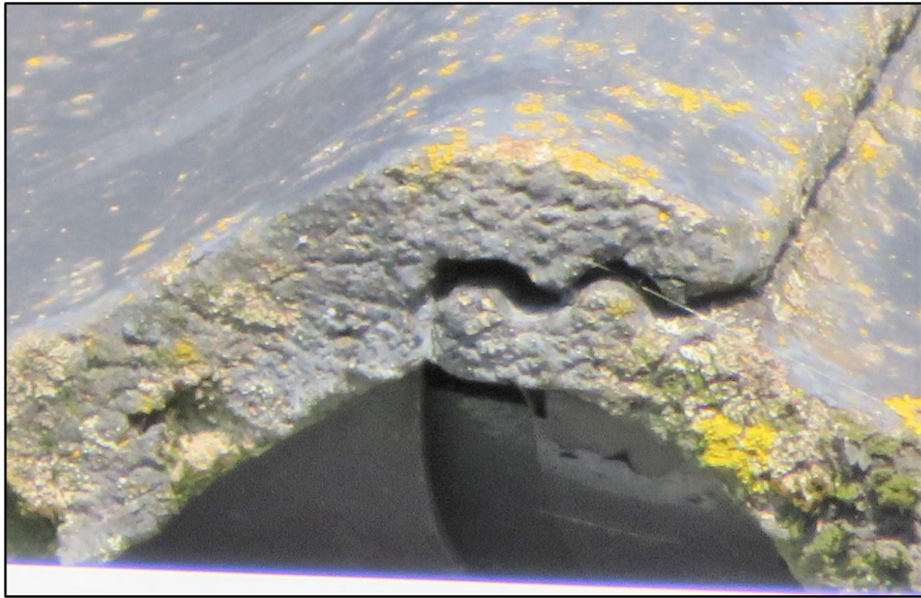
Figuur 5 Onder de dakpannen is geen geschikte ruimte voor huismusnesten.
