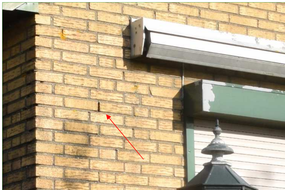
Open stootvoeg kan toegang geven voor vleermuis geschikte ruimten.
