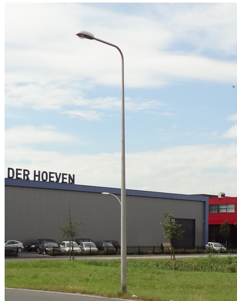
armatuur langs bedrijfsstraat
