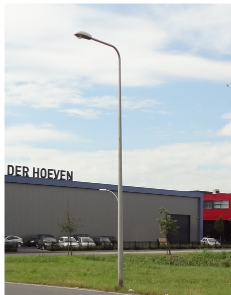
armatuur langs bedrijfsstraat
