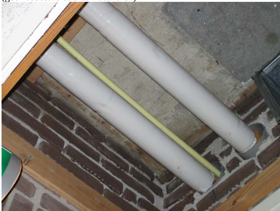
Foto 4: de leidingen op de begane grond zijn geïsoleerd met schuim en kunststof (geen asbestverdachte materialen)
