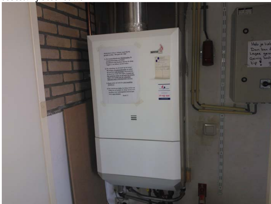
Foto 2: de cv-ketel van het merk “Nefit 30305 combi” is gebouwd na 1994 en daarom asbestvrij beschouwd
