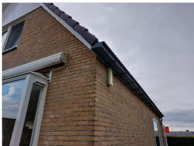
Figuur 5.1 Het woonhuis met aan de rechterkant de zuidgevel met een dakgoot en openingen tussen de dakpannen.
