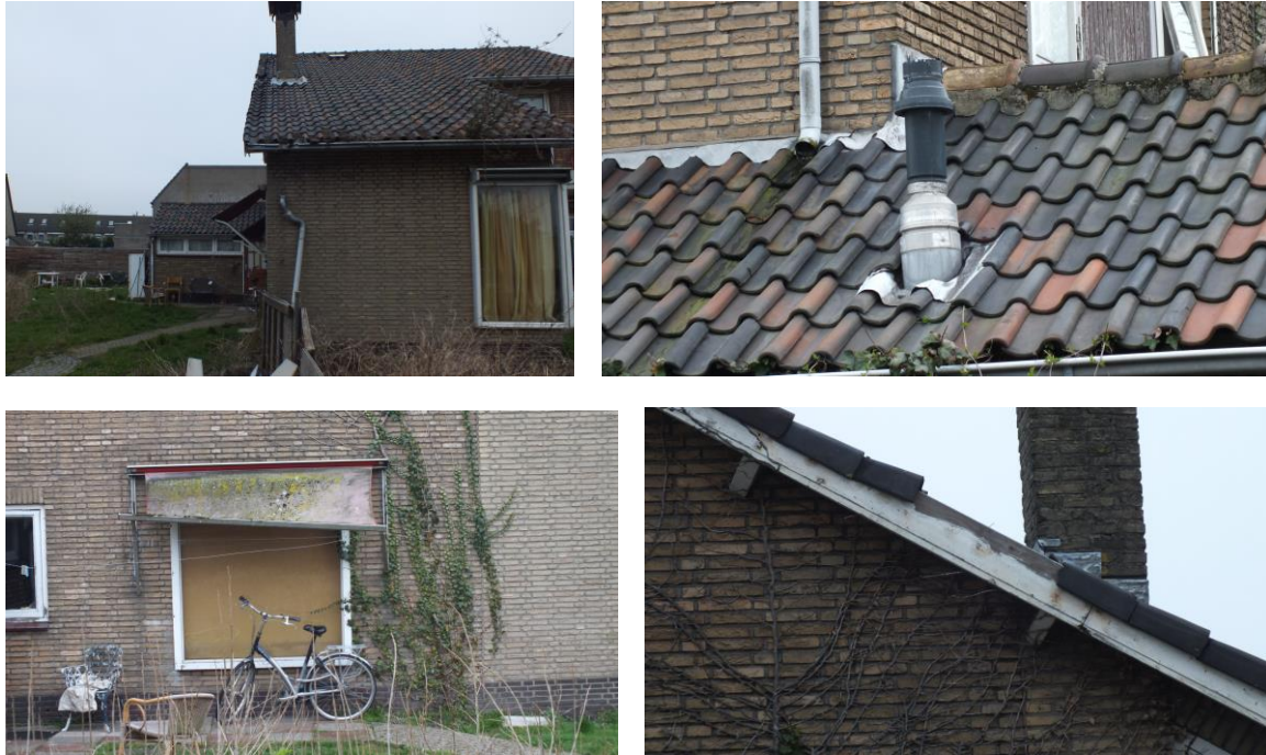
Figuur 5.1. Ontstane potentiële verblijfplaatsen voor gebouwbewonende vleermuizen door verval, schade en achterstallig onderhoud.
