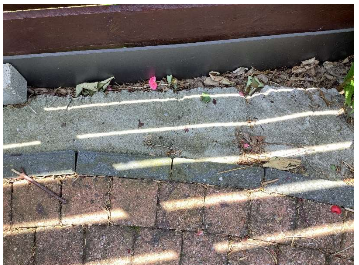
foto 6: betonplaat onder klinkers
