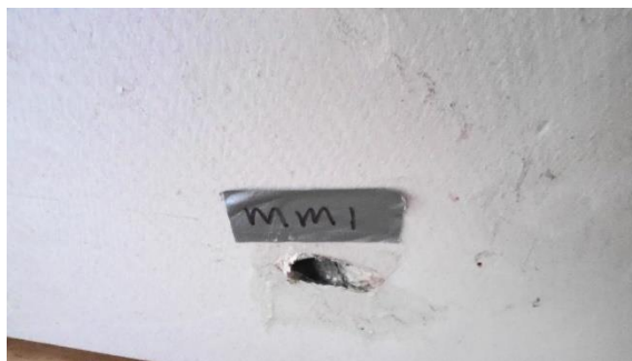
Foto 2. Asbesthoudende plafondbeplating (bron Bron1)
