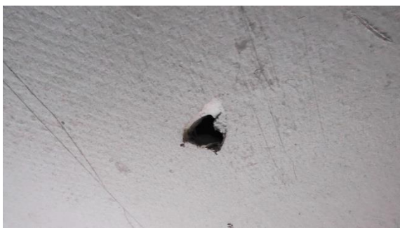
Foto 5. Asbesthoudende plafondbeplating (bron Bron1)
