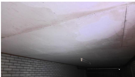
Foto 1. Asbesthoudende plafondbeplating (bron Bron1)
