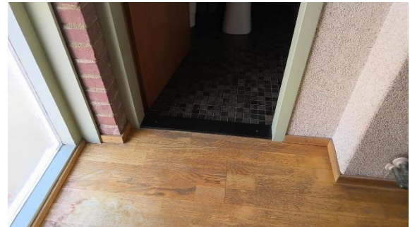
Foto 20. Asbesthoudende dorpel (bron Bron4)
