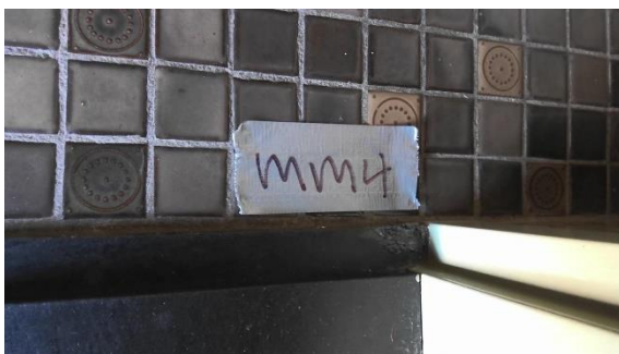
Foto 21. Asbesthoudende dorpel (bron Bron4)
