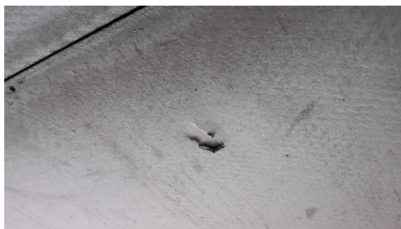
Foto 4. Asbesthoudende plafondbeplating (bron Bron1)
