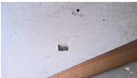
Foto 3. Asbesthoudende plafondbeplating (bron Bron1)
