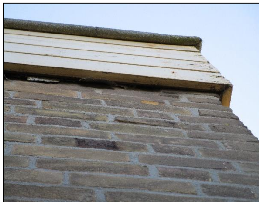
Figuur 5: spleet tussen houtwerk en muur
