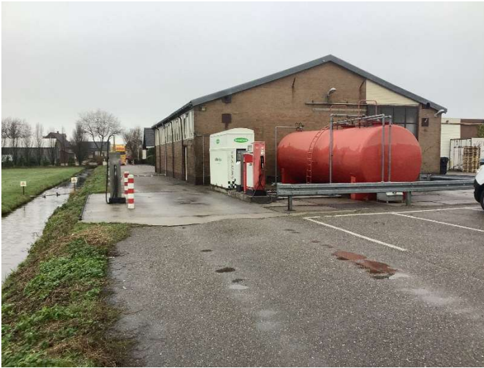
foto 1: pompeiland met toebehoren (diesel en AdBlue)
