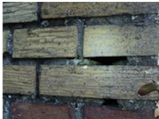
Het voegwerk is op verschillende plekken beschadigd.
