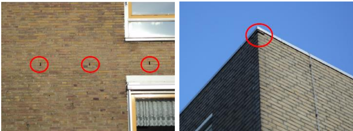
Afbeelding 1a. Open stootvoegen waar vleermuizen toegang hebben tot de spouwmuur en b. Losse stenen onder de dakrand waar vleermuizen naar binnen kunnen.
