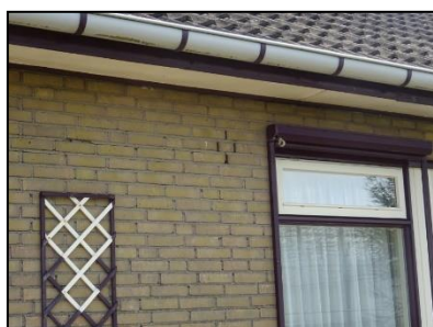
Figuur 6. Open stootvoegen in de gevel bij de woning aan de zuidkant van de onderzoekslocatie.
