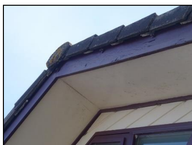
Figuur 7. Overhangende kantpannen bij de woning aan de zuidkant van de onderzoekslocatie.
