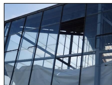
Figuur 13. Ontbrekend raam in de centraal gelegen schuur.
