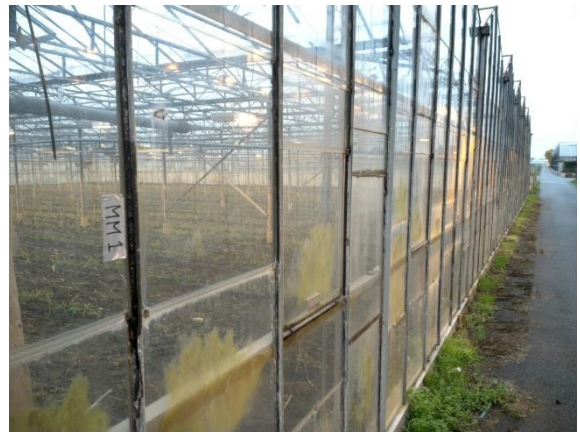
Foto 2. Asbesthoudende kaskit op gevelroeden (bron Bron1)
