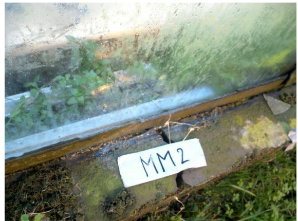
Foto 22. Asbesthoudende kaskit op voetrand (bron Bron2)
