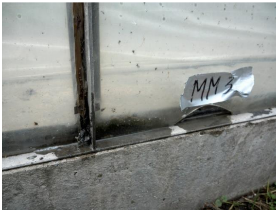
Foto 7. Asbesthoudende kaskit op gevelroeden (bron Bron1)
