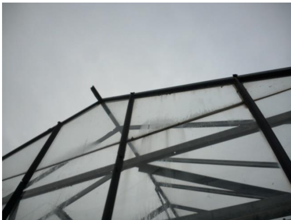
Foto 9. Asbesthoudende kaskit op gevelroeden (bron Bron1)
