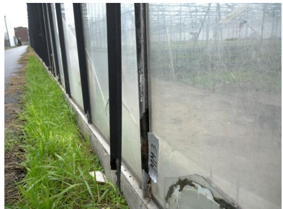
Foto 6. Asbesthoudende kaskit op gevelroeden (bron Bron1)
