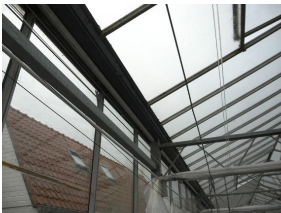
Foto 29. Asbesthoudende kaskit op goot (bron Bron3)
