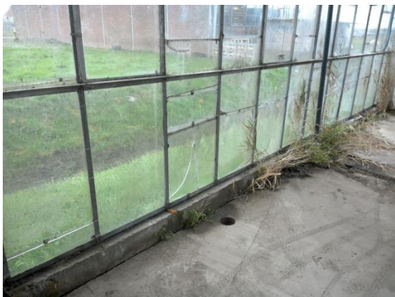
Foto 27. Asbesthoudende kaskit op voetrans (bron Bron2)
