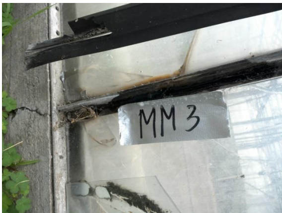
Foto 5. Asbesthoudende kaskit op gevelroeden (bron Bron1)
