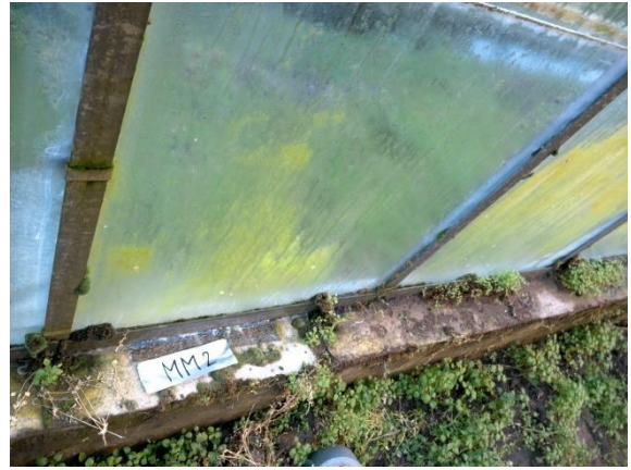
Foto 20. Asbesthoudende kaskit op voetrand (bron Bron2)
