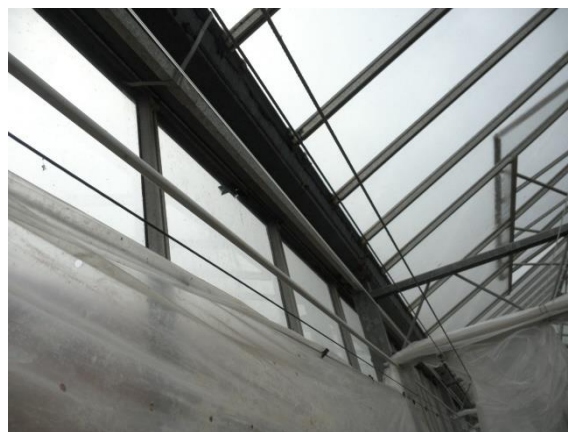
Foto 30. Asbesthoudende kaskit op goot (bron Bron3)
