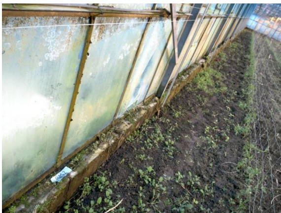
Foto 25. Asbesthoudende kaskit op voetrans (bron Bron2)
