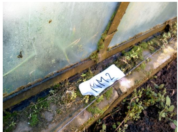
Foto 24. Asbesthoudende kaskit op voetrand (bron Bron2)
