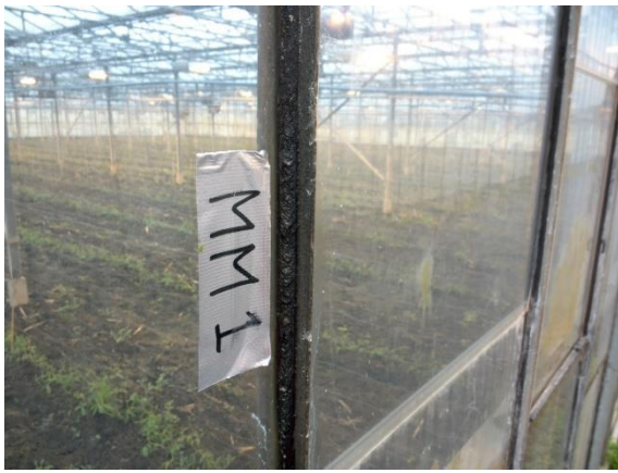
Foto 1. Asbesthoudende kaskit op gevelroeden (bron Bron1)
