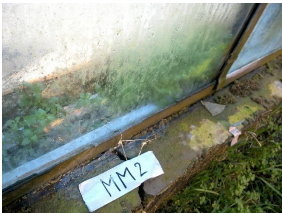
Foto 23. Asbesthoudende kaskit op voetrand (bron Bron2)
