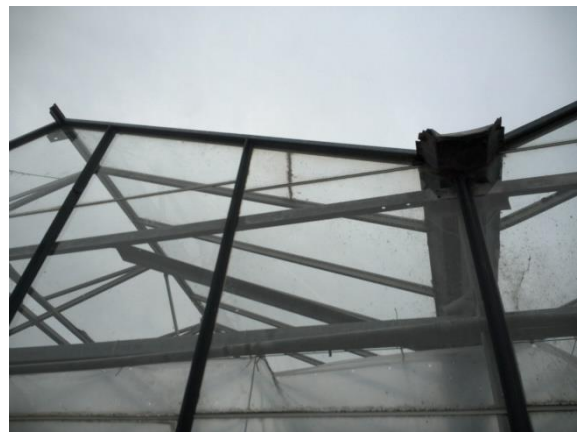
Foto 12. Asbesthoudende kaskit op gevelroeden (bron Bron1)
