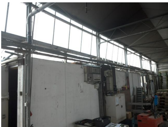
Foto 17. Asbesthoudende kaskit op gevelroeden (bron Bron1)
