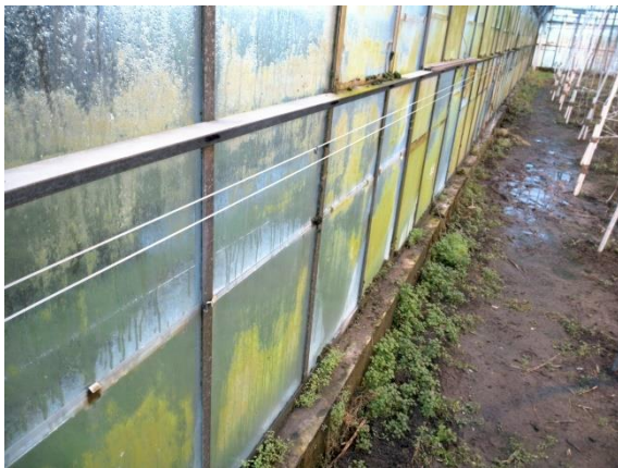
Foto 21. Asbesthoudende kaskit op voetrand (bron Bron2)
