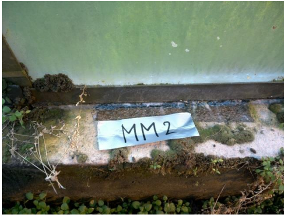
Foto 19. Asbesthoudende kaskit op voetrand (bron Bron2)
