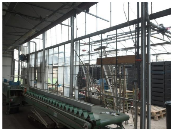
Foto 16. Asbesthoudende kaskit op gevelroeden (bron Bron1)
