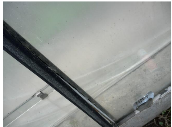
Foto 10. Asbesthoudende kaskit op gevelroeden (bron Bron1)
