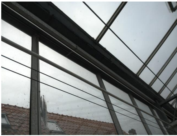
Foto 31. Asbesthoudende kaskit op goot (bron Bron3)
