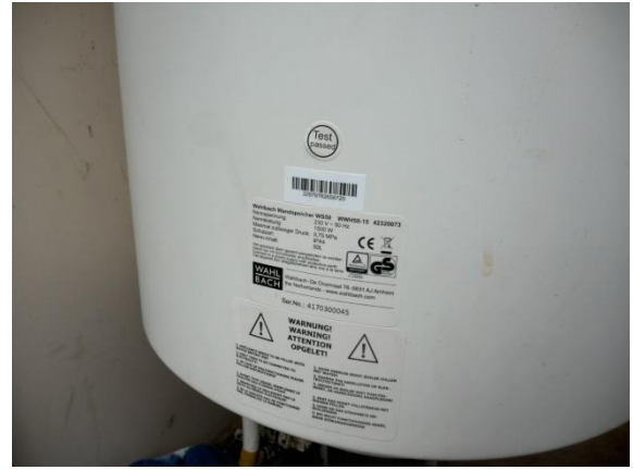
45. Boiler in bedrijfsruimte
