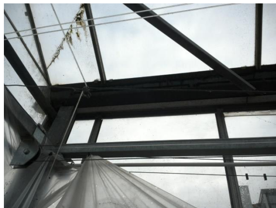
Foto 28. Asbesthoudende kaskit op goot (bron Bron3)
