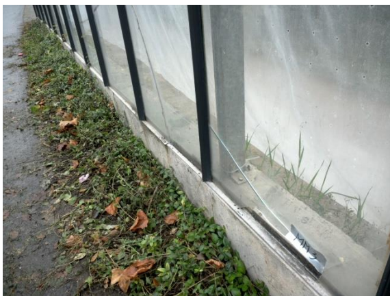
Foto 13. Asbesthoudende kaskit op gevelroeden (bron Bron1)
