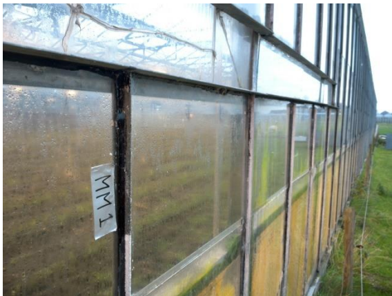
Foto 3. Asbesthoudende kaskit op gevelroeden (bron Bron1)
