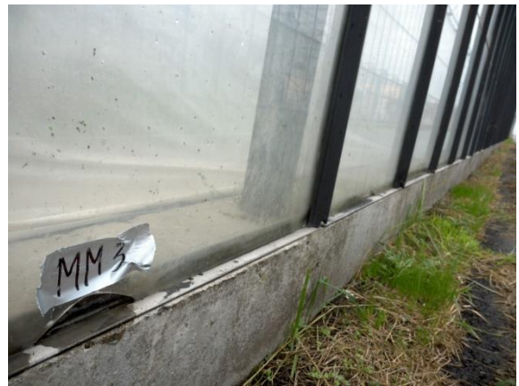
Foto 8. Asbesthoudende kaskit op gevelroeden (bron Bron1)
