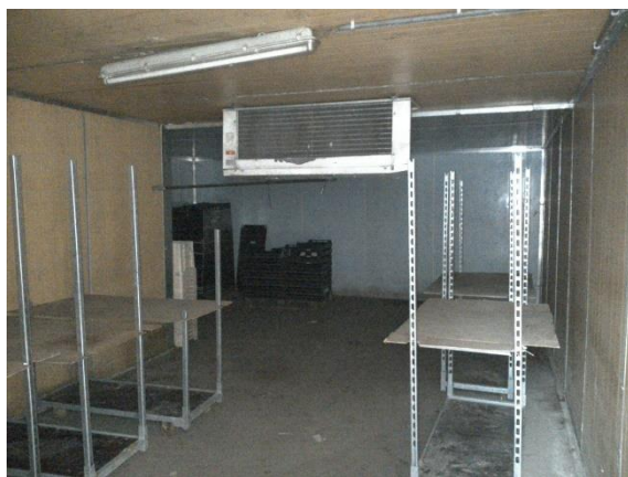
61. Koelcel in bedrijfsruimte 3
