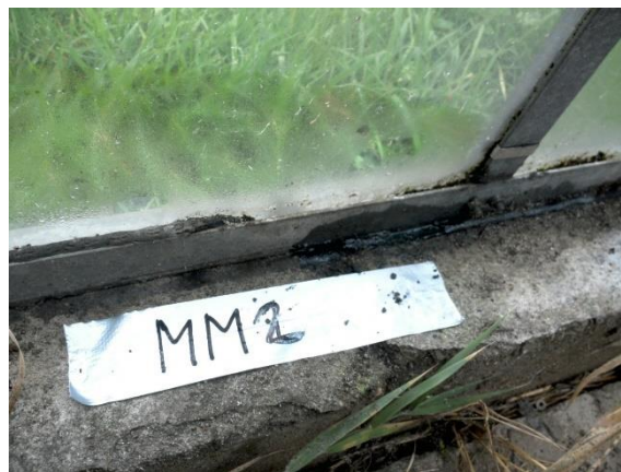
Foto 26. Asbesthoudende kaskit op voetrans (bron Bron2)
