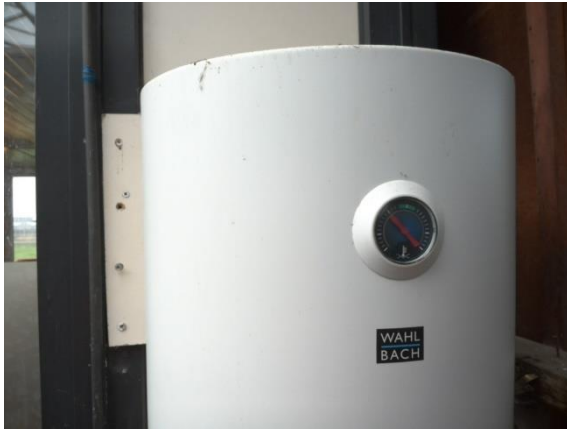
44. Boiler in bedrijfsruimte
