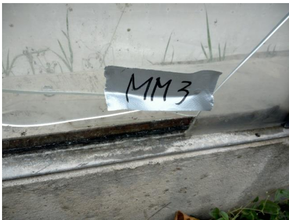
Foto 11. Asbesthoudende kaskit op gevelroeden (bron Bron1)
