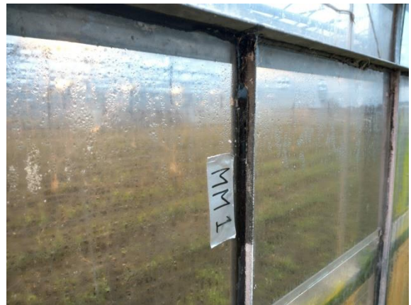
Foto 4. Asbesthoudende kaskit op gevelroeden (bron Bron1)
