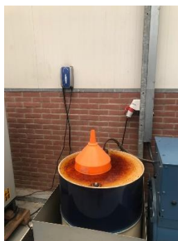
Foto 10 : Dieseltank in lekbak
