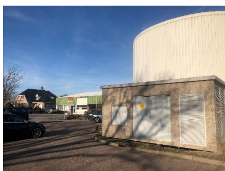
Foto 3 : Aanzicht locatie (transformatorhuisje)
