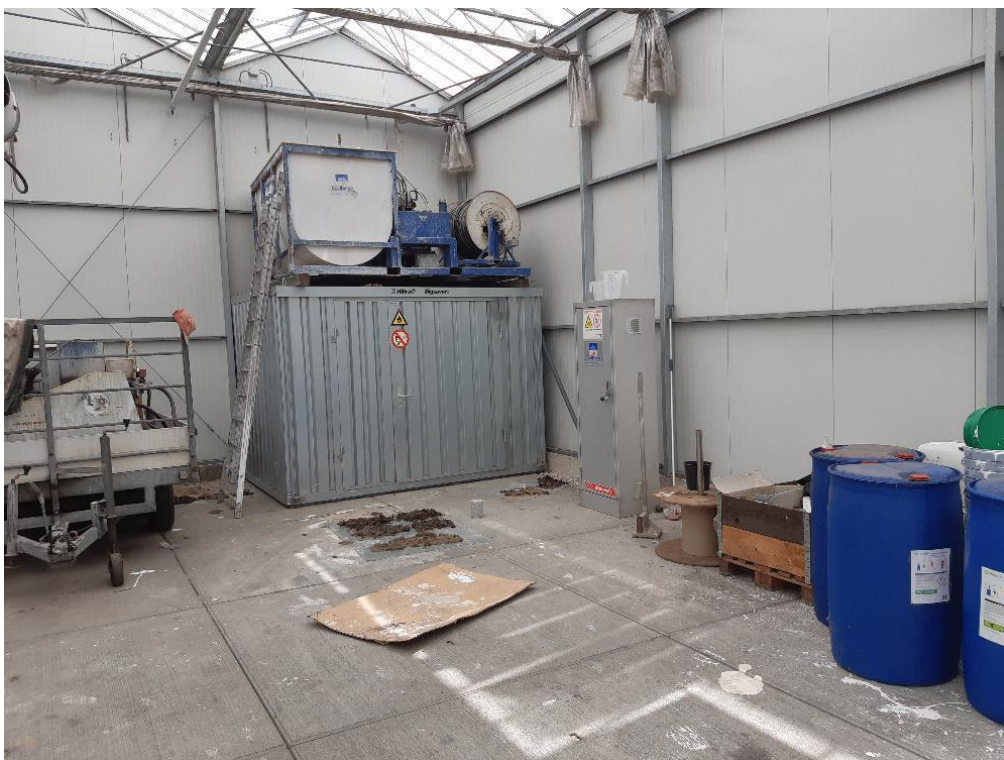
Foto 2: Chemicaliënopslag met lekbak en bestrijdingsmiddelenkast in bedrijfshal
