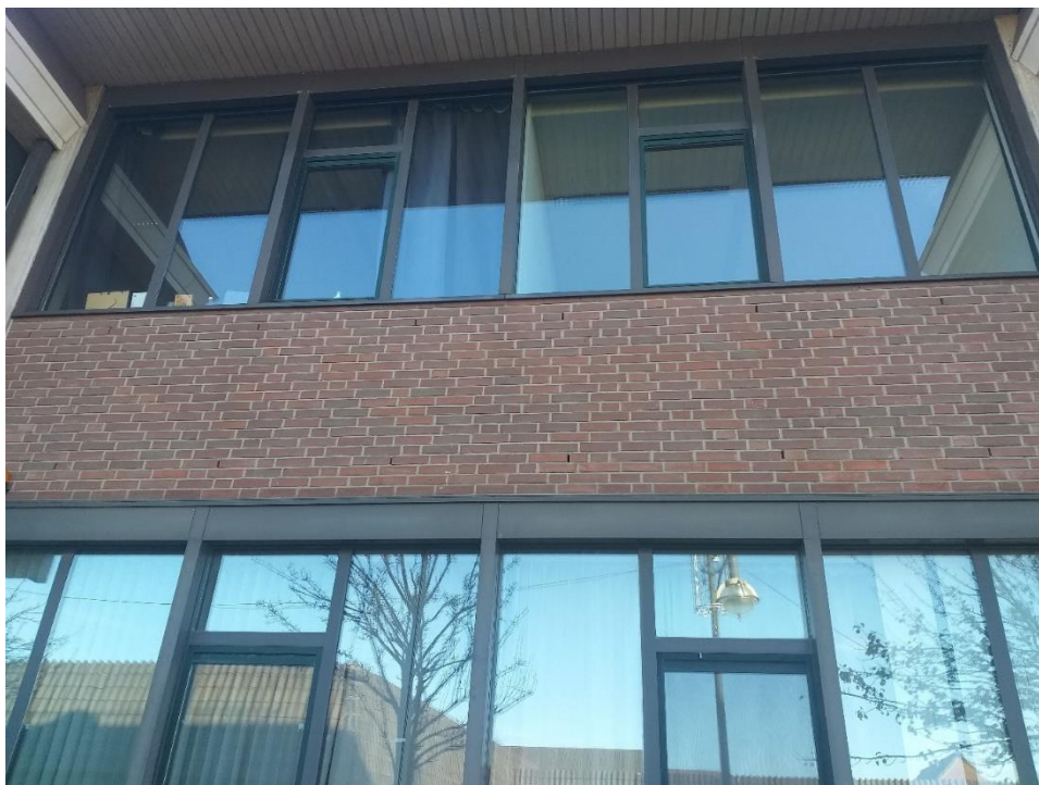
Figuur 5.1 Bakstenen gevel met open stootvoegen
