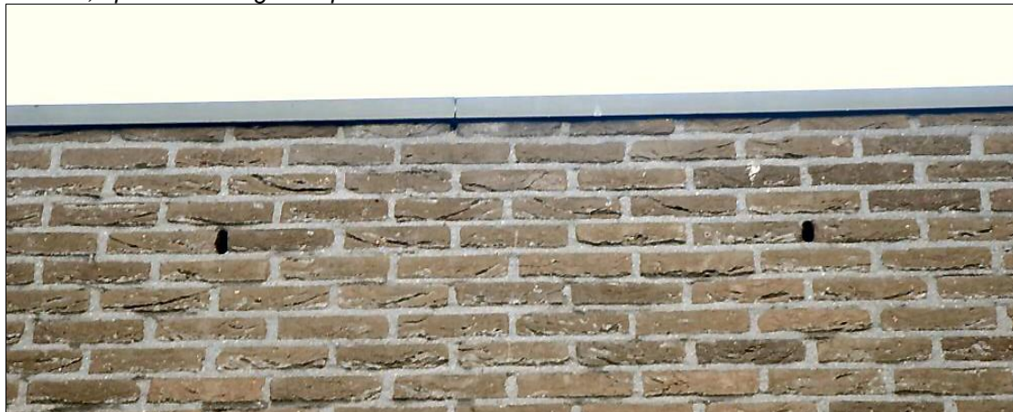
Foto 24, open stootvoegen Supermarkt
