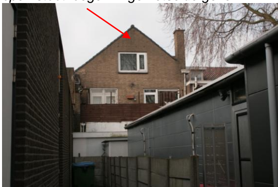
Foto 5, achterzijde Langestraat, met o.m. open stootvoegen in gemetselde gevel
