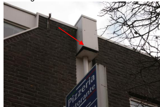
Foto 8, kapotte constructies met plaatselijk oude vogelnesten
