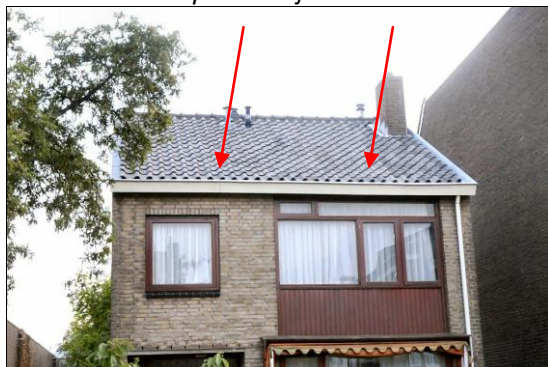
Foto 20, P.v.M.straat 8, 2 gierzwaluwnesten onder onderste pannenrij
