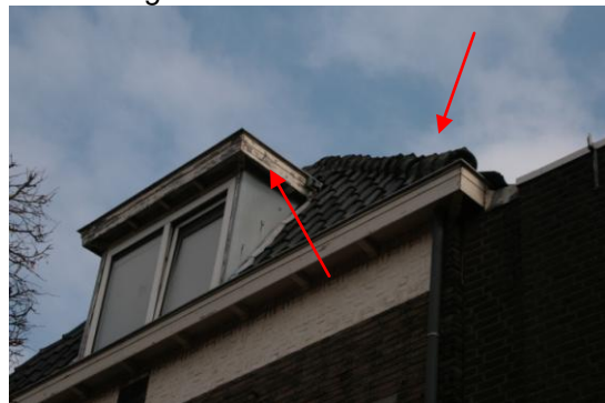
Foto 7, oude dakpannen, achterstallig beheerde constructies
