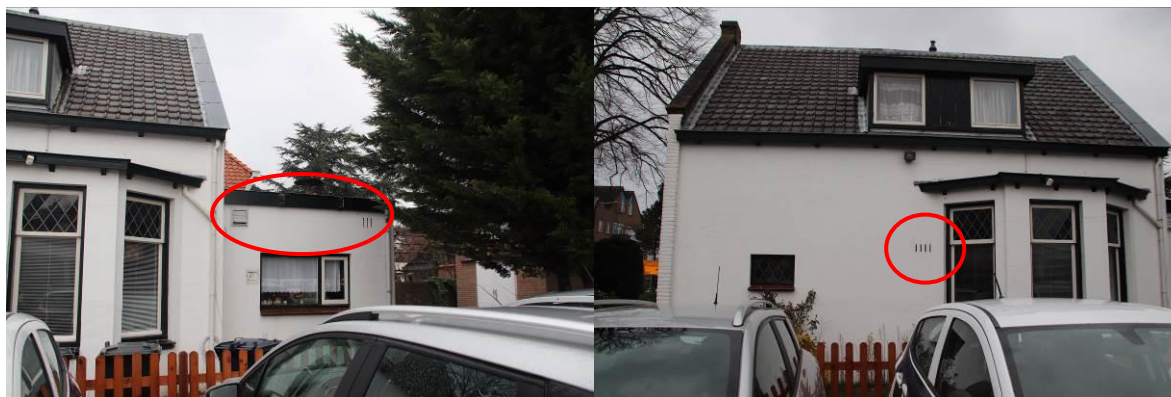
Figuur 5.2. Open stootvoegen in de woning (rood omcirkeld).
