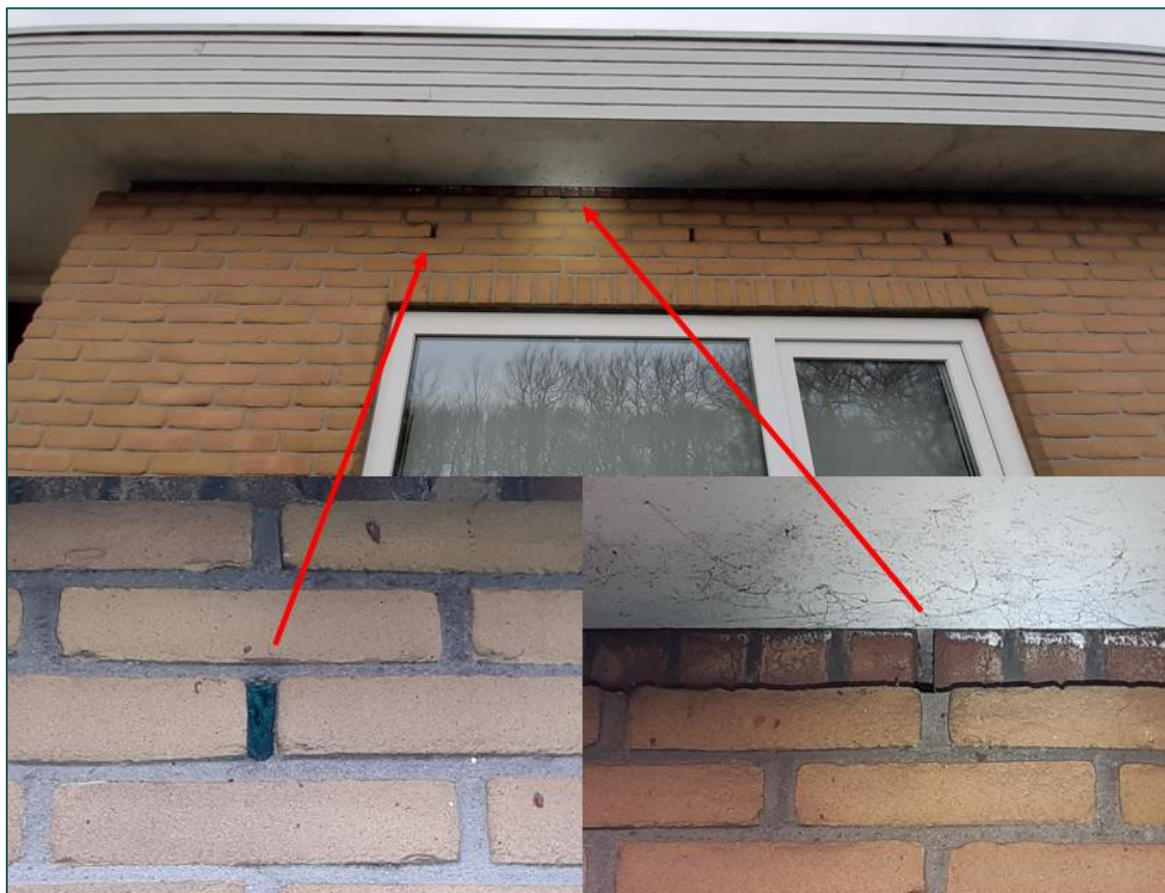
Figuur 1.4 Enkele stootvoegen in de woning zijn dichtgestopt met gaas. Dit geldt echter niet voor alle stootvoegen waardoor er mogelijk verblijfplaatsen van vleermuizen aanwezig kunnen zijn.
