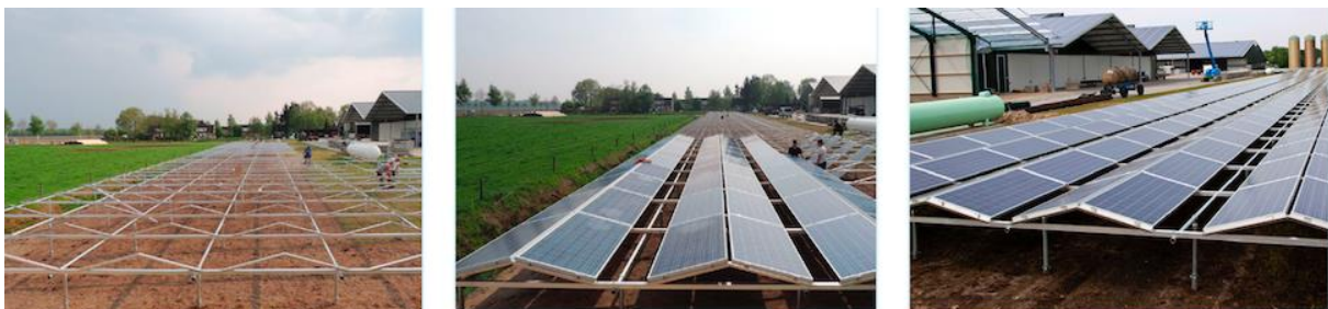
Figuur 3. Oost-west opstelling zonnepanelen.
