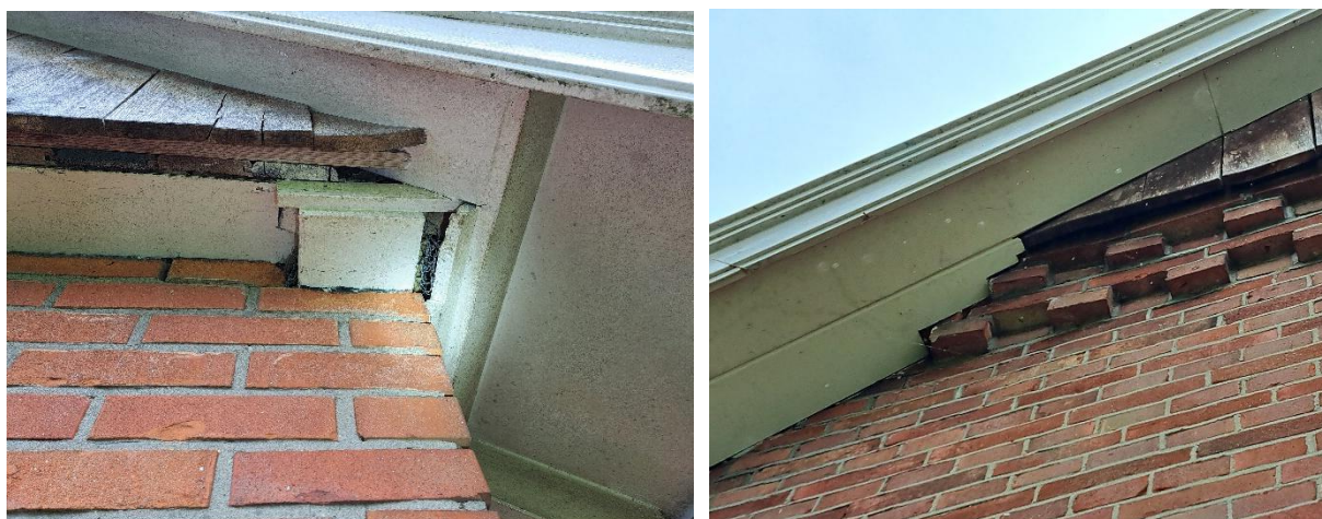
Figuur 8 & 9: Weergave kieren bij dakoverstek en gevelbetimmering
