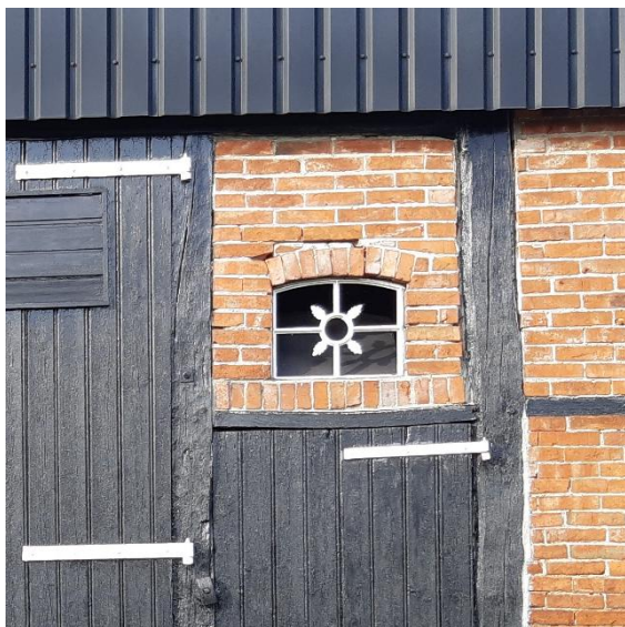
Scheuren rondom stalraam in voorgevel
