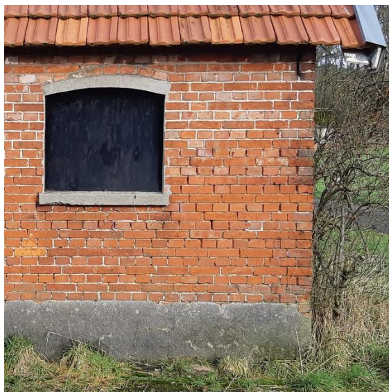
Op meerder plekken is voegwerk verdwenen
