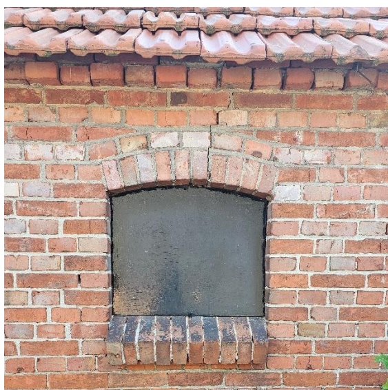
Scheurvorming boven stalramen linkerzijgevel
