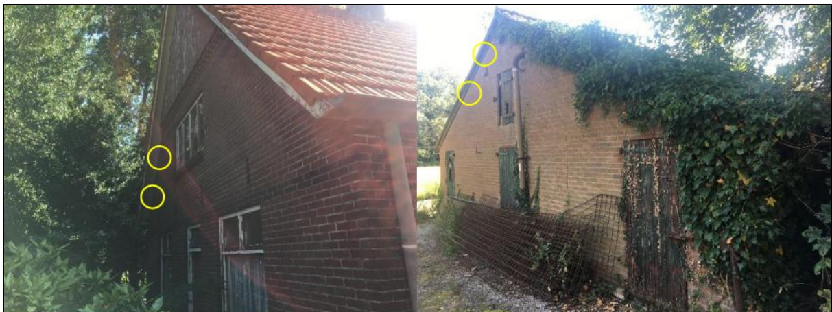
Foto 2 links: tussen het metselwerk en de betimmering van de dakoverstek zijn kieren vastgesteld (gele cirkels). Foto 3 rechts: kieren tussen metselwerk en daklijsten (gele cirkels).
