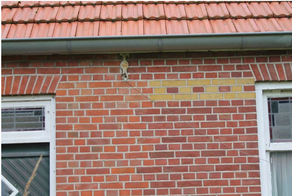
Foto westgevel bouwsporen afwijkend metselwerk
