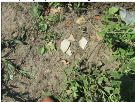
Asbestplaatsjes op maaiveld t.h.v. gat 01
