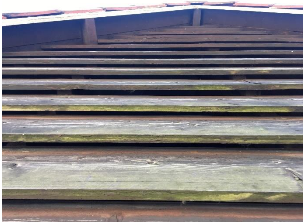
De planken sluiten nauw op elkaar aan en er zijn geen openingen waargenomen.
