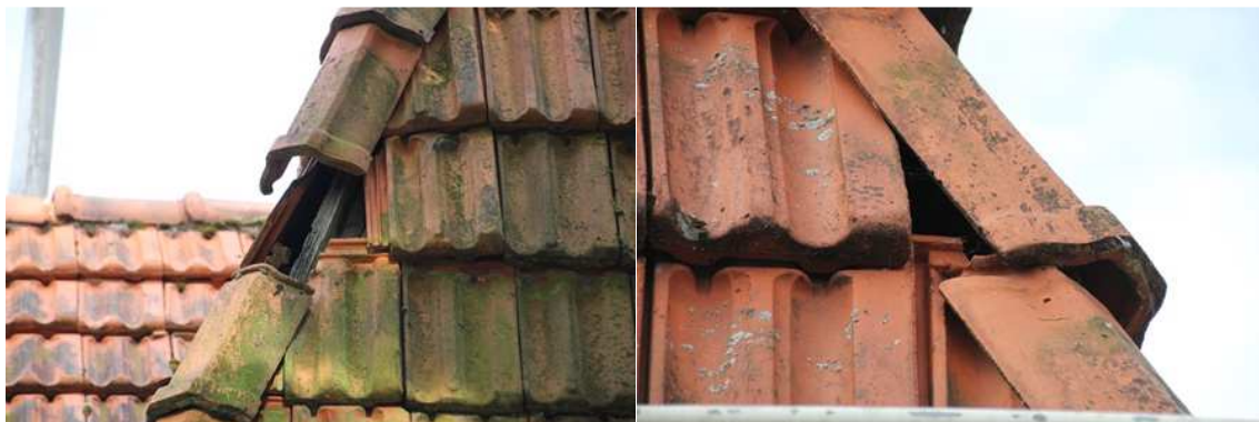
Gaten en kieren in het dakvlak; potentiële nestplaats voor vogelsoorten als huismus en gierzwaluw.
