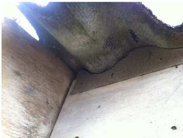
Afdichting van de openingen aan de onderzijde van de golfplaten; hierdoor kunnen steenmarters niet onder de golfplaten komen.
