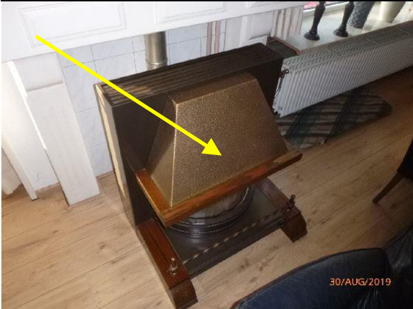
Asbestverdachte gashaard in de woonkamer.
