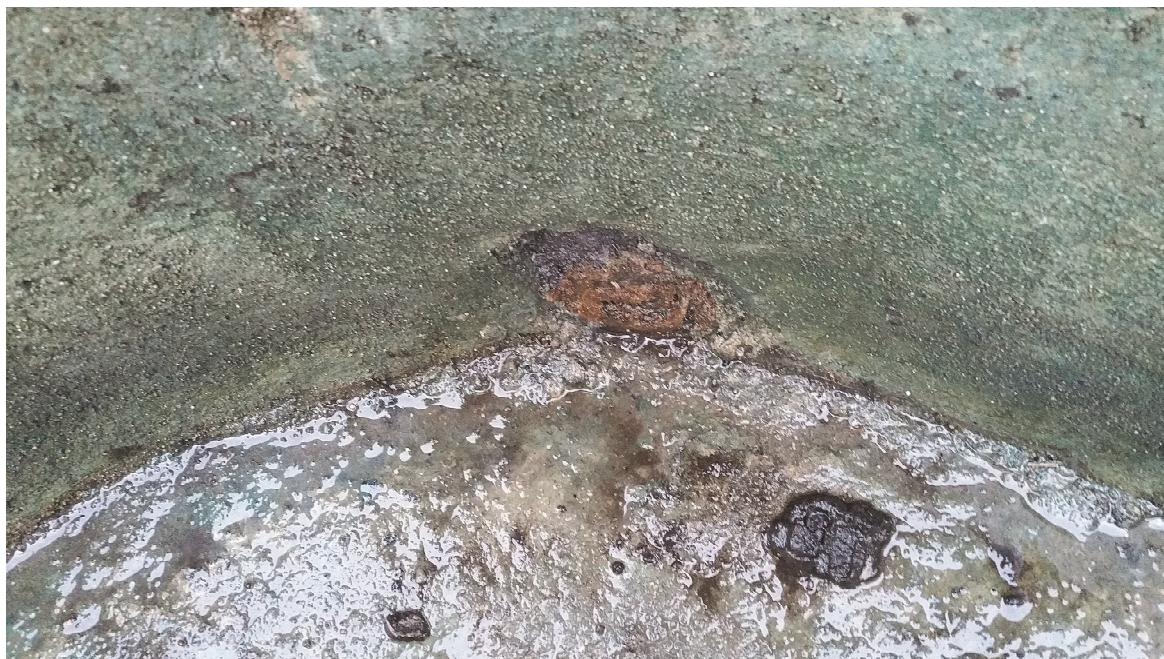
Afbeelding 5.9 | In het beton van het aslager is een houten plug aanwezig.
