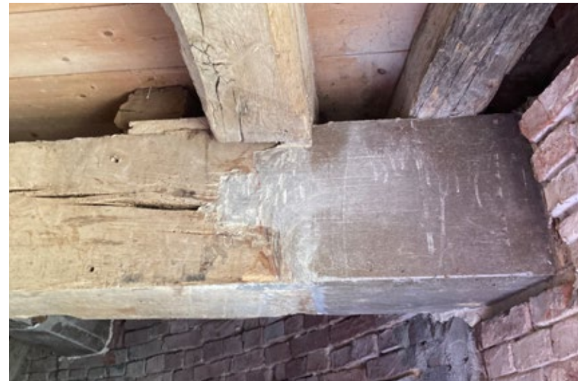
Hoognodige reparatie, ten aanzien van behoud houtwerk.
