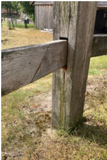
Hoognodige reparatie, ten aanzien van behoud houtwerk
