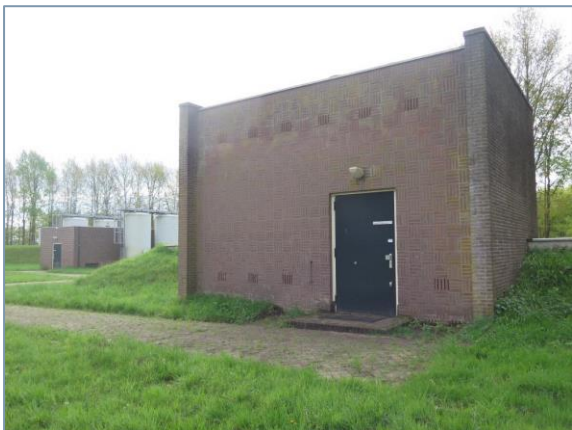
Foto 1. Gebouw met geschikte en/of toegankelijke verblijfruimten voor vleermuizen in de vorm van diverse ventilatiegaten.
