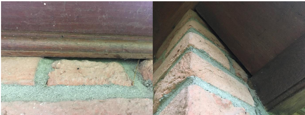
Tussen het metselwerk en de houtbetimmering zijn kieren vastgesteld. Dit biedt vleermuizen de kans een verblijfplaats te bezetten achter de gevelbetimmering.
