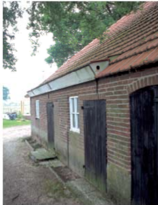
Een creatief aangelegde nestkast: een geïntegreerde nestkast als onderdeel van de dakgoot.
