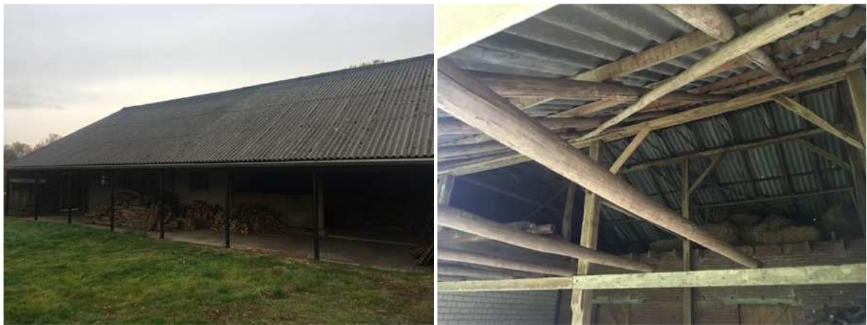
Kapschuur in het plangebied; deze kapschuur vormt een geschikte nestplaats voor vogels.
